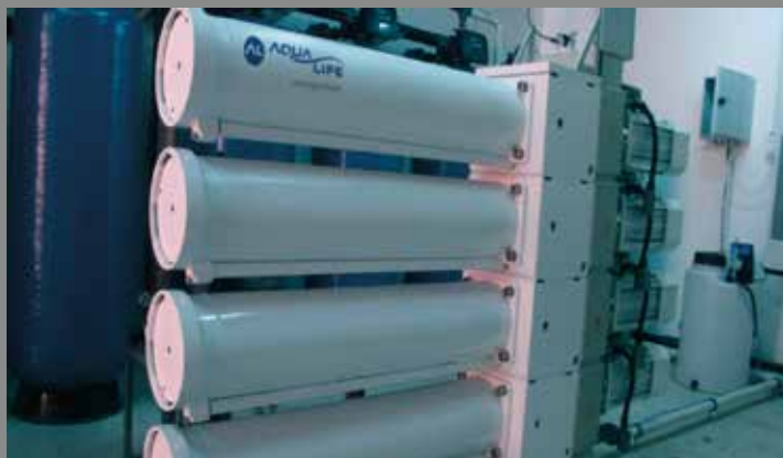
پلنت تصفیه آب DBASW۰۳۰ - ۴ - ۱۲۰ - همراه با UF ، روسیه
